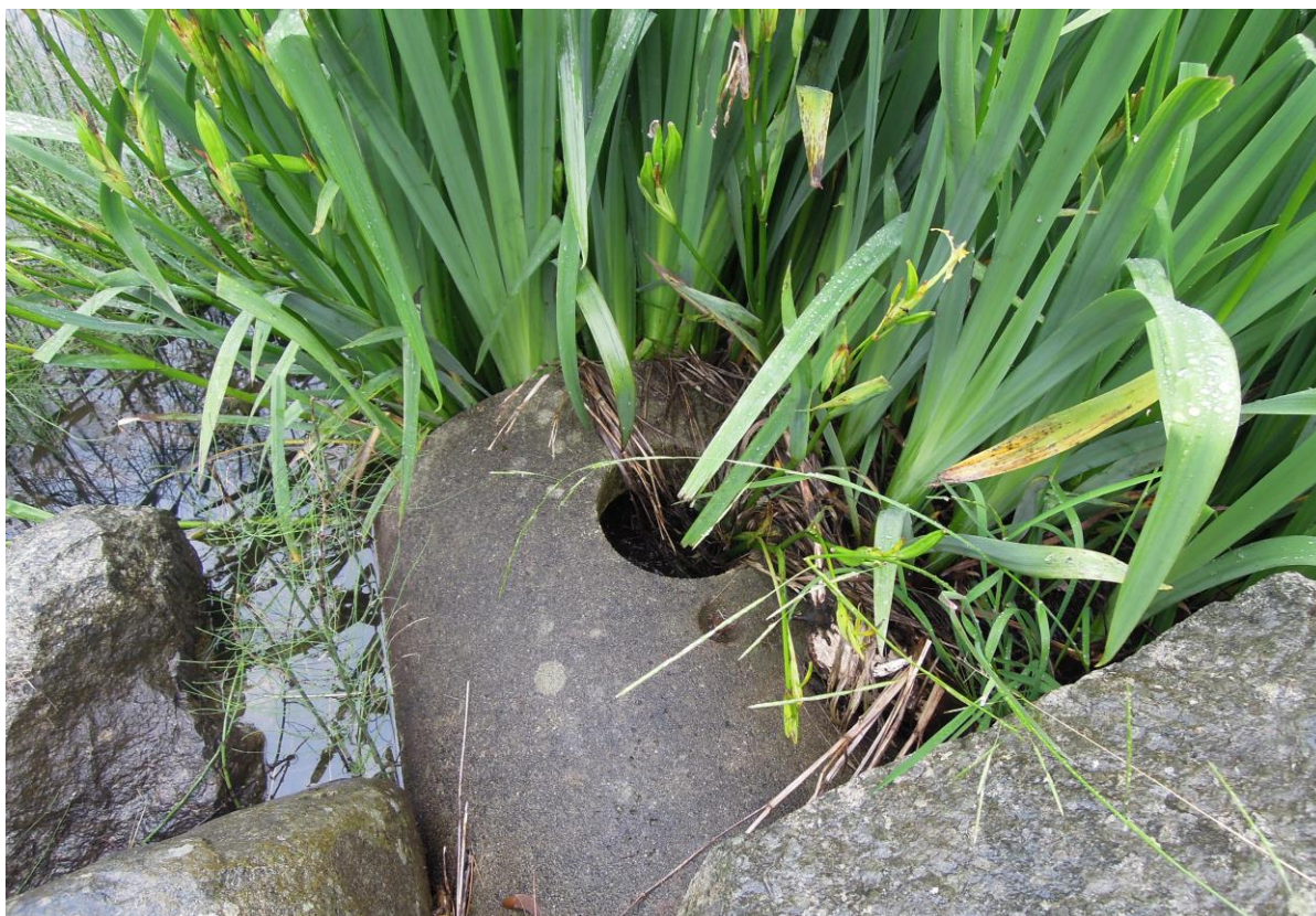
Figur 13. Inngang rør i Lille Berlandshølen var tett av sverdililjer. Til tross for vannføring rundt 75 persentilet var det lite gjennomstrømming i røret.
